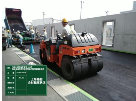
◎この工事はアスファルト舗装を2層に行いますが、そのうちの1層目が終わりました。
